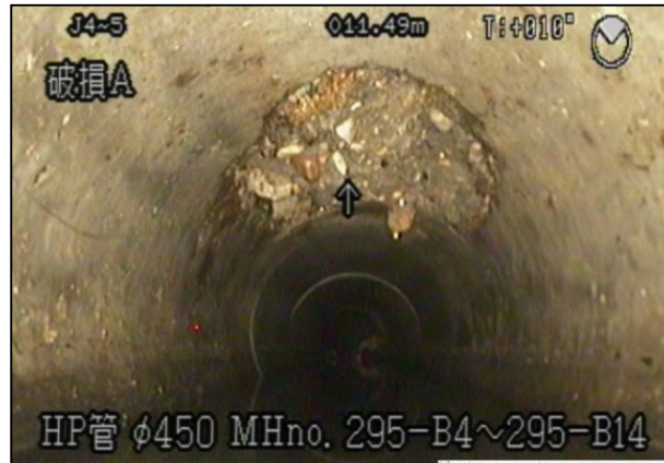
破損した下水道管路
