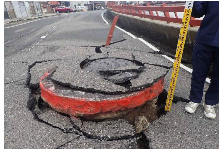
マンホール浮上
