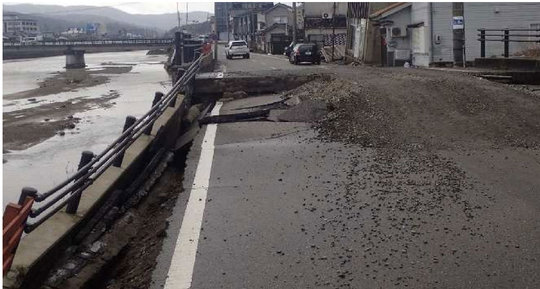
周辺地盤の沈下
