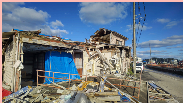
2024/1 能登半島地震被災家屋（輪島市）
