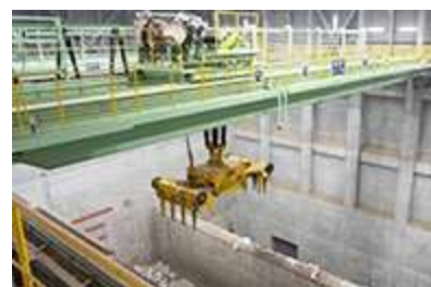
高座清掃施設組合処理施設
