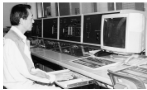
水質や水量などを常時監視する水道施設監視システム
