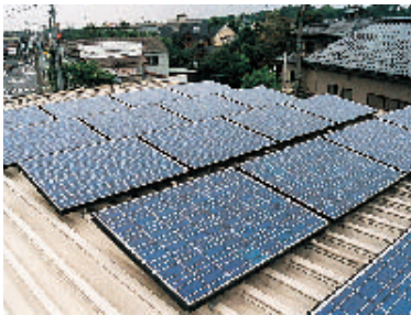
住宅用太陽光発電設備
