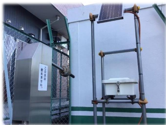
自動記録式地下水位計
