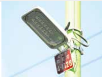
設置されたLED防犯灯
