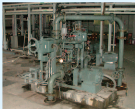
地下水を汲み上げるポンプ
