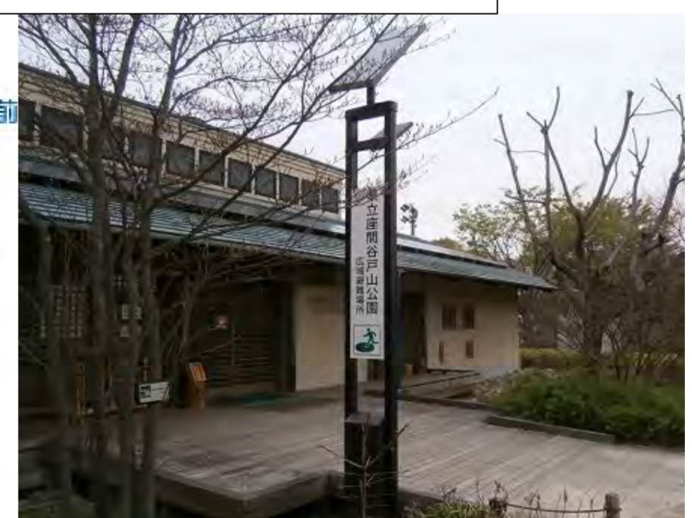
ソーラーパネルと蓄電池 ソーラー照明灯
