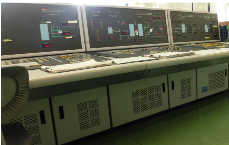
写真 四ツ谷配水管理所中央監視室
