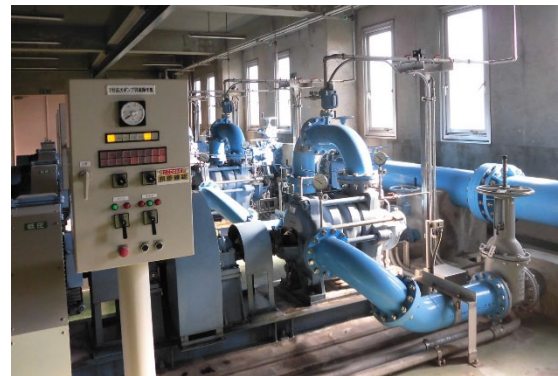
四ツ谷配水管理所ポンプ室（右）
