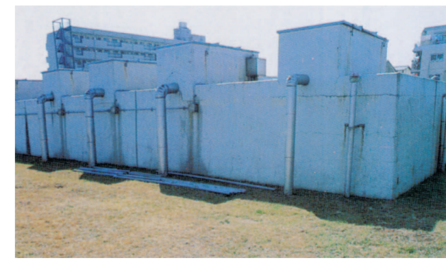
相模が丘地域の配水を担っている相模が丘配水場
