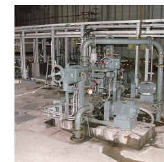
しずくの水源地 主力水源である 第1水源のポンプ施設
