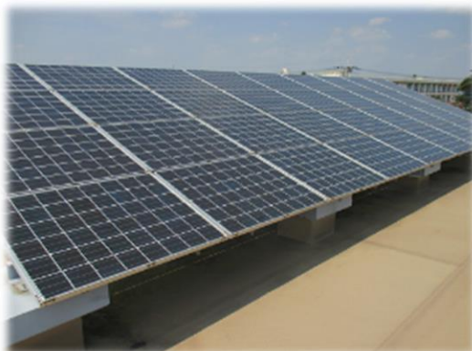
栗原コミュニティセンターの 屋上に設置されている 太陽光発電設備（令和2年8月撮影）
