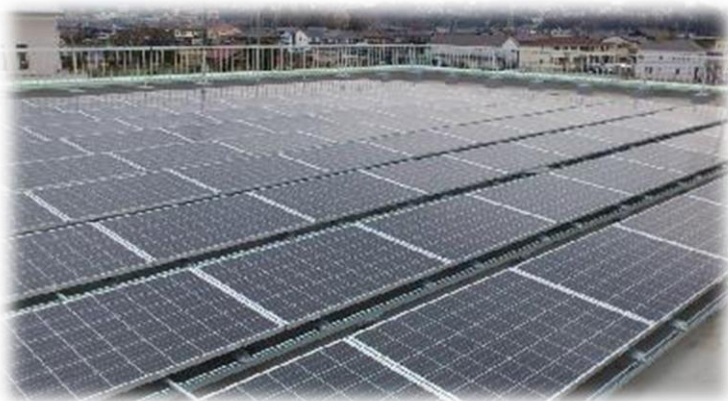
四ツ谷配水管理所の屋上に設置されている太陽光発電設備
