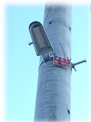
市内に設置されたLED防犯灯（平成27年2月撮影）
