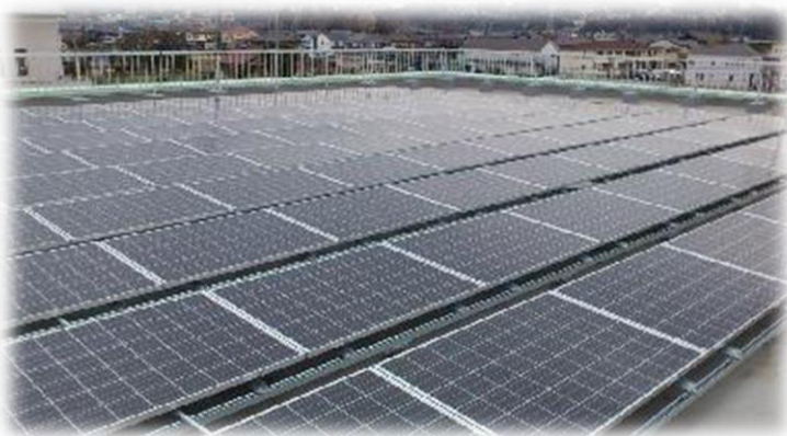
四ツ谷配水管理所の屋上に設置されている太陽光発電設備 （平成28年2月撮影）
