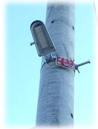
市内に設置されたLED防犯灯（平成27年2月撮影）
