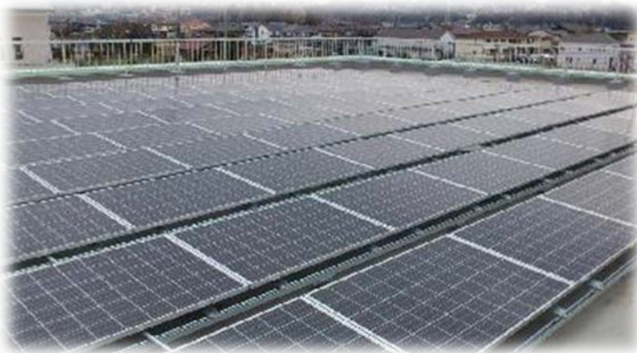
四ツ谷配水管理所の屋上に設置されている太陽光発電設備 （平成28年2月撮影）
